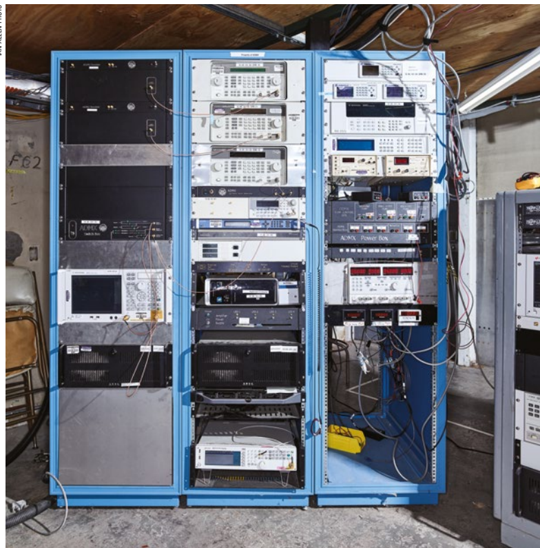
Komplexe Elektronik steuert das Experiment (links) und liefert den Ingenieure die Daten der Sensoren (rechts).
